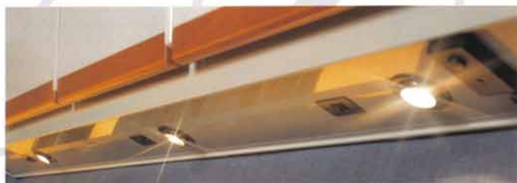
Die integrierte Deckenbeleuchtung mit Alu-Profil
